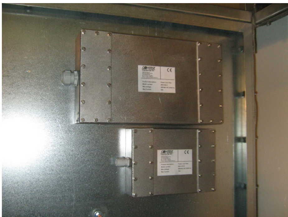
Filtration pour les lignes de puissance
